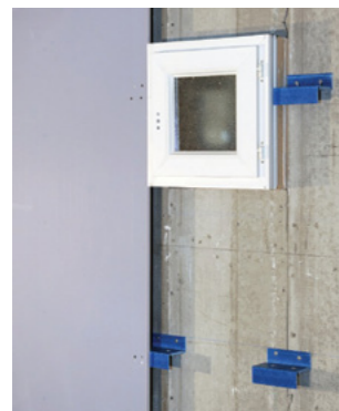
Ajout d'appuis au droit des côtés verticaux de la menuiserie ; plaques positionnées au droit de la menuiserie.
