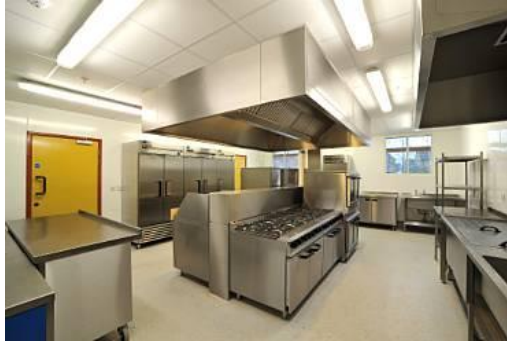
Plafond « Royal Hygiène de chez Rockfon »
