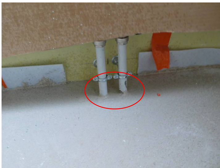
Absence de fourreau résilient en traversée de chape flottante, bande périphérique absente entre la chape et la cloison
