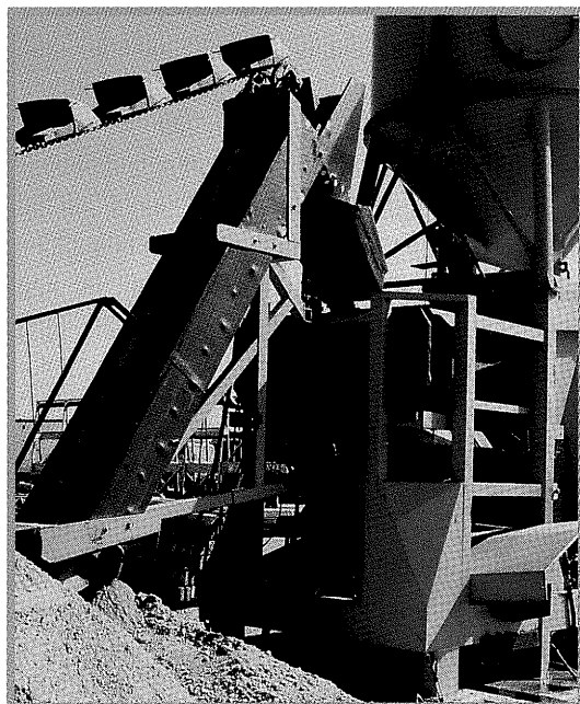
Centrale à béton insonorisée.
