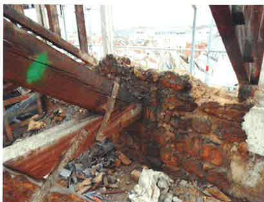
20.02 : maçonnerie à consolider par BEC Construction
