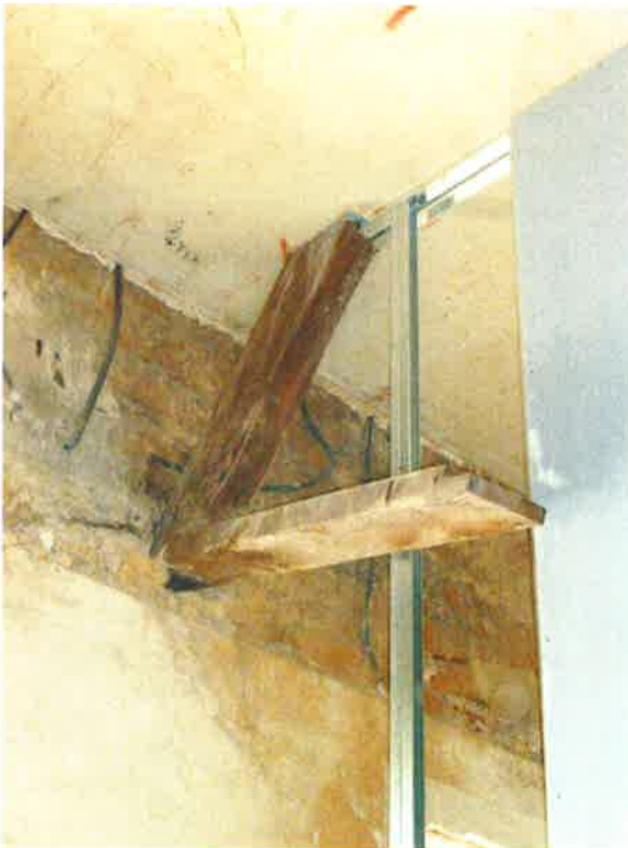
19.06 : pièce d'appui à couper, trou à boucher
