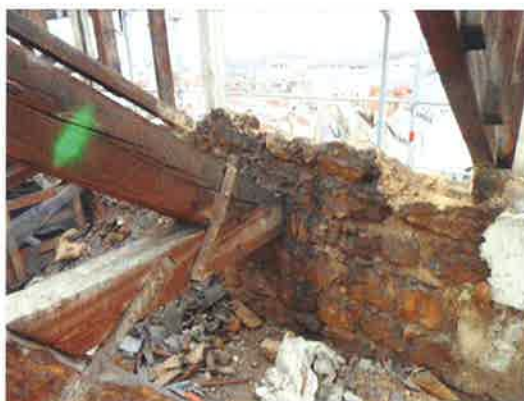
20.02 : maçonnerie à consolider par BEC Construction 03.07 : travaux non exécutés par BEC Construction, maçonneries dissimulées / isolant sur rampant.
