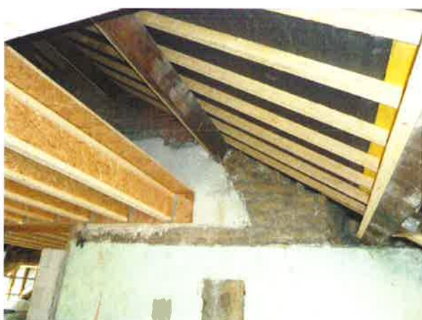
05.05 : liaison plancher / rampant non conforme au DCE, à modifier par C2C
