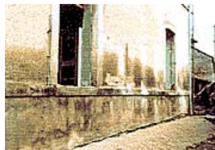
Mur dégradé par l'humidité
