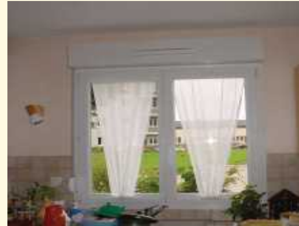
Présence d'entrée d'air dans pièce de service
