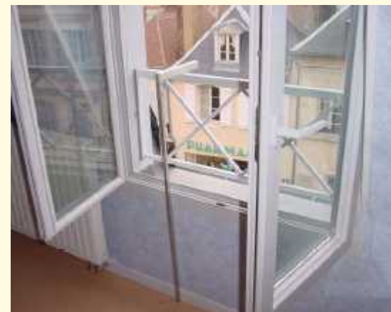
Fenêtre avec barre d'appui < à 1m de hauteur
