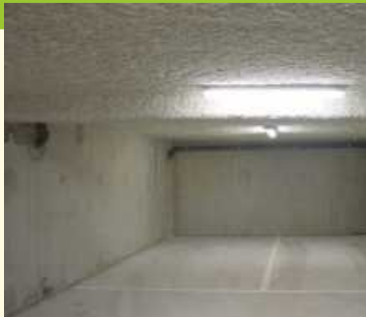
Absence de ventilation Haute ou Basse
