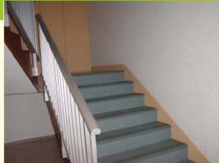
Absence d'une 2ème main courante pour les bâtiments sans ascenseur
