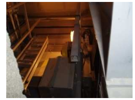
Figure 15 : Vue sur la machinerie en cages ascenseur
